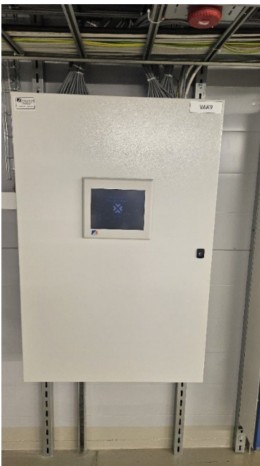
Kuva 4. Esimerkki valvonta-alakeskuksesta. Keskellä olevasta näytöstä voidaan tehdä ohjausta.
